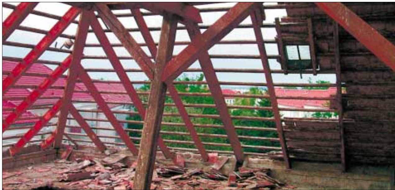
Die Kraft des Blitzes hat... das Dach abgedeckt...
