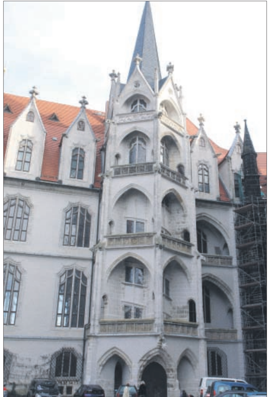
Risse gibt es am Großen Wendelstein der Albrechtsburg schon lange. Entstehen sie, weil der Turm sich neigt? Nahezu permanente Messungen durch TUD-Wissenschaftler sollen aufklären, wie sich das Bauwerk verhält. Foto: UJ/Geise
