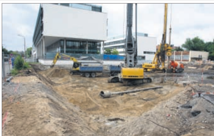
Der Blick auf die Baustelle am Tatzberg zeigt den Standort des neuen Gebäudekomplexes neben dem jetzigen BIOZ. Foto: UJ/Eckold
