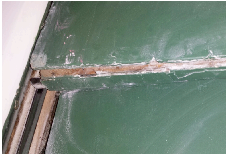
Abbildung 1: Schäden an der Tafel im Raum BAR 213
