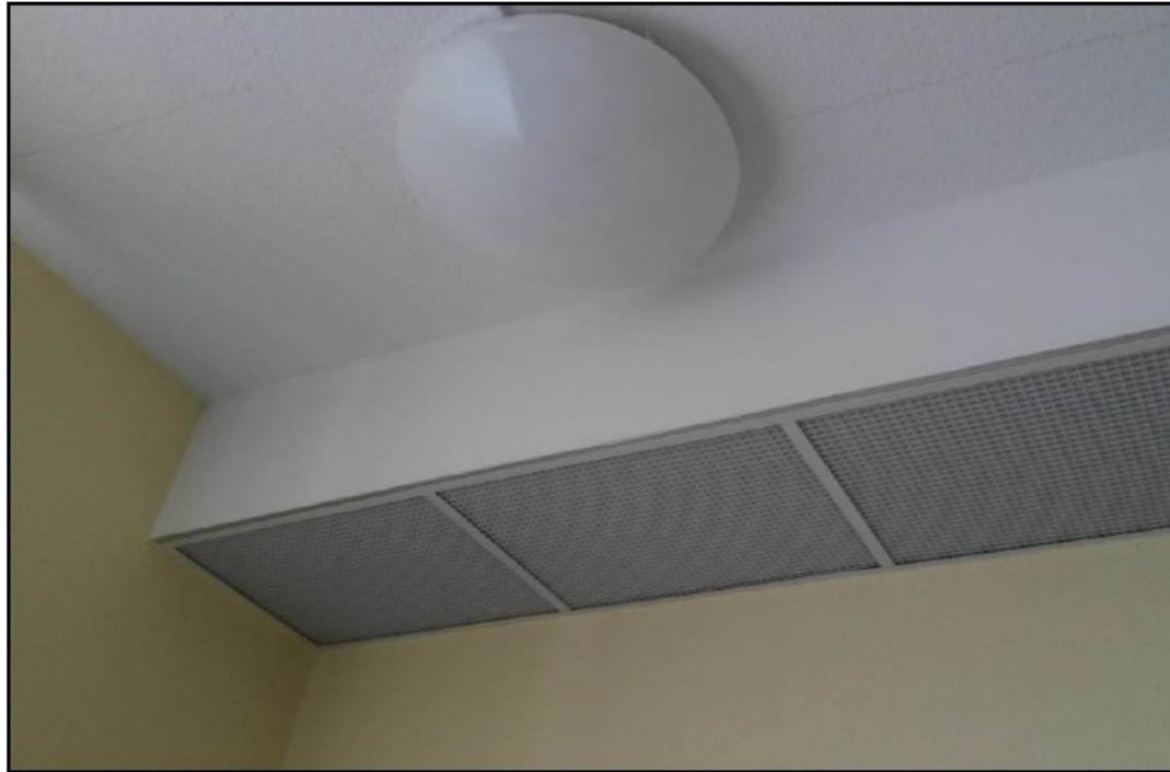
Abbildung 19: Kantenabsorber zwischen Wand und Decke
